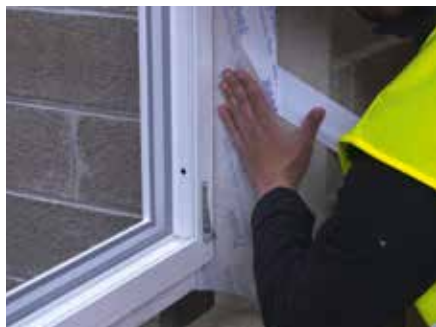
1. Usunąć folię zabezpieczającą i zamocować taśmę klejącą Tyvek® Plastering Tape 150 mm na wewnętrznej stronie okna.
